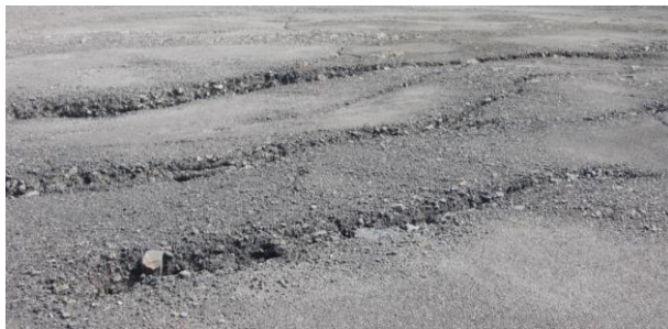
Abbildung 2: Risse auf der Haldenoberfläche
